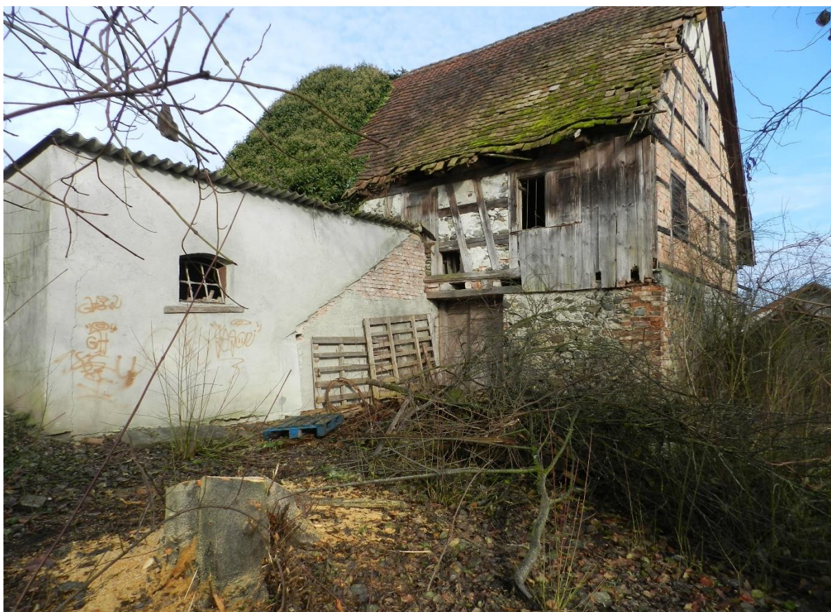
Abbildung 4: marodes Fachwerkhaus mit vorgelagerter Garage östl. d. Geltungsbereichs
